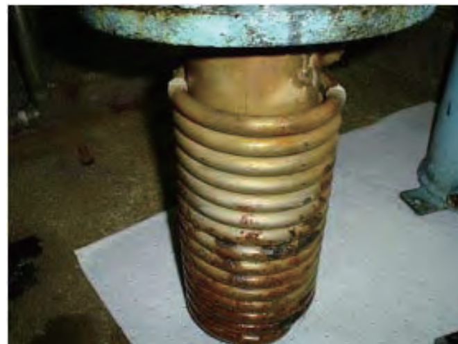
錆による腐食が止まり一部黒錆化している。
