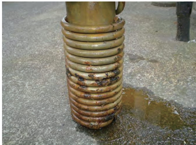
錆でチューブが腐食しかけている。
